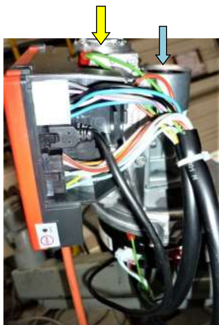
Ensemble contrôle de flamme et injection du mélange air-gaz, entrée supérieure gaz.
